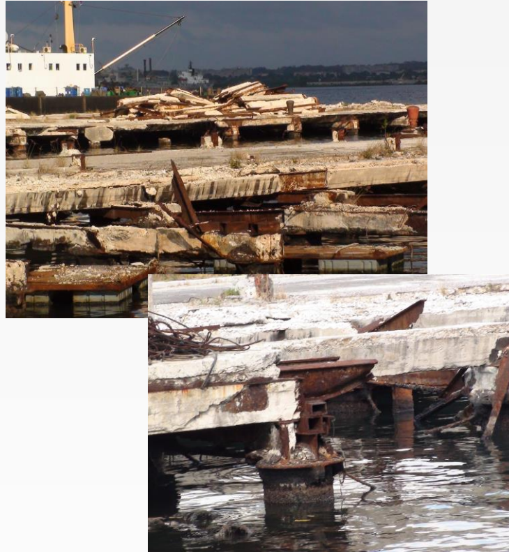
Corrosão marina "Puerto de La Havana" Havana Velha, 28/01/2012
